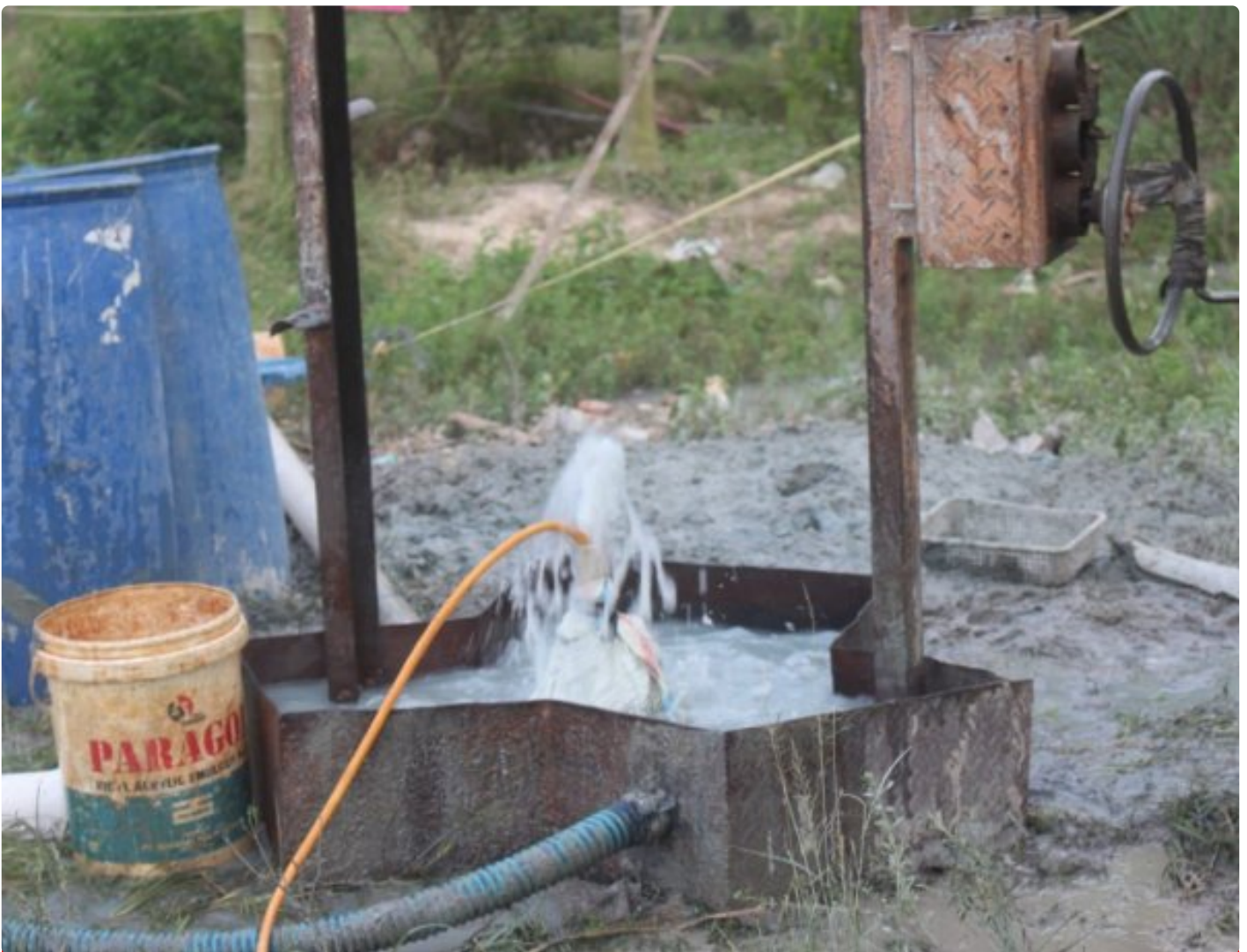
Sumber air bersih dari program unggulan Kasad di TMMMD ke 120 Kodim 0209/LB
